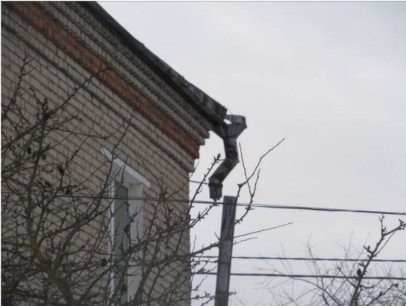
Фото 2. Вид состояния организованной водосточной системы здания. Имеет она повреждения возможные к исправлению текущими ремонтами.
