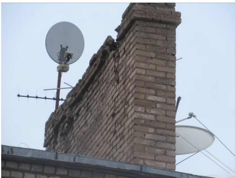
Фото 6. Вид состояния следующего по ходу осмотра выпуска вент. канала над крышей здания. Присутствует уже разрушение и обрушение части кладки.
