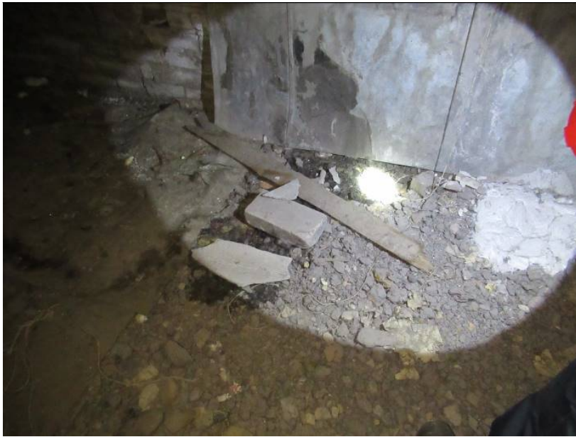
Фото 10. Вид вент. канала со стороны чердачного помещения здания. Присутствуют протечки и намокание кладки вент. канала и близ расположенного котельного шлака утепления чердачного перекрытия.
