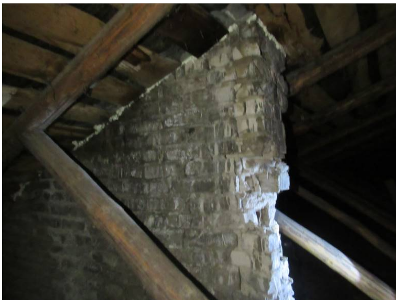
Фото 11. Вид вышележащего участка вент. канала в чердачном помещении здания. Часть кирпичной кладки уже разрушена и обрушена. Оставшаяся кладка имеет следы многолетних намоканий.
