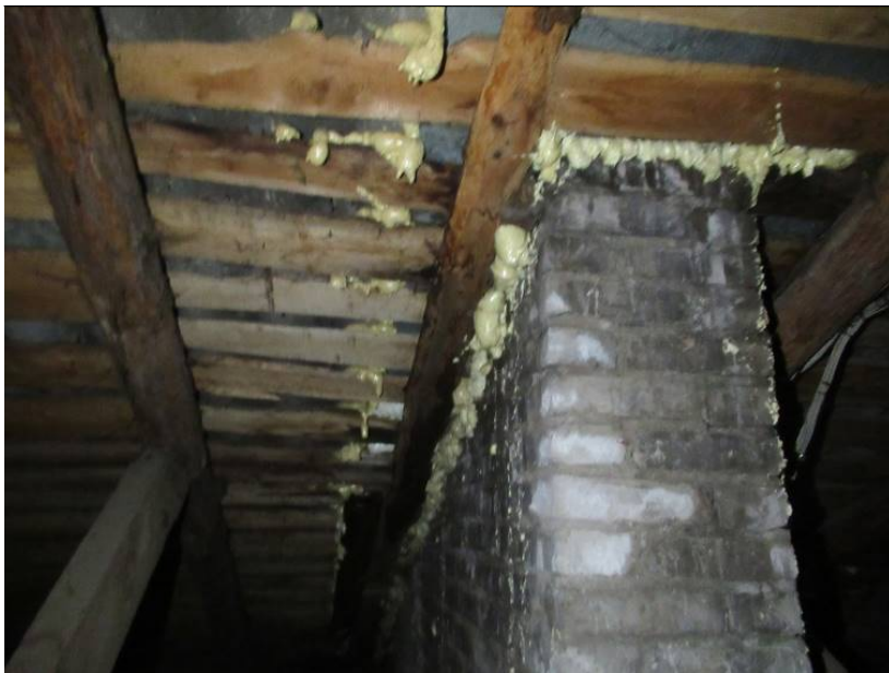
Фото 13. Вид намокшей кладки вент. канала под загерметизированным монтажной пеной примыканием кровли. Протечки не устранены.
