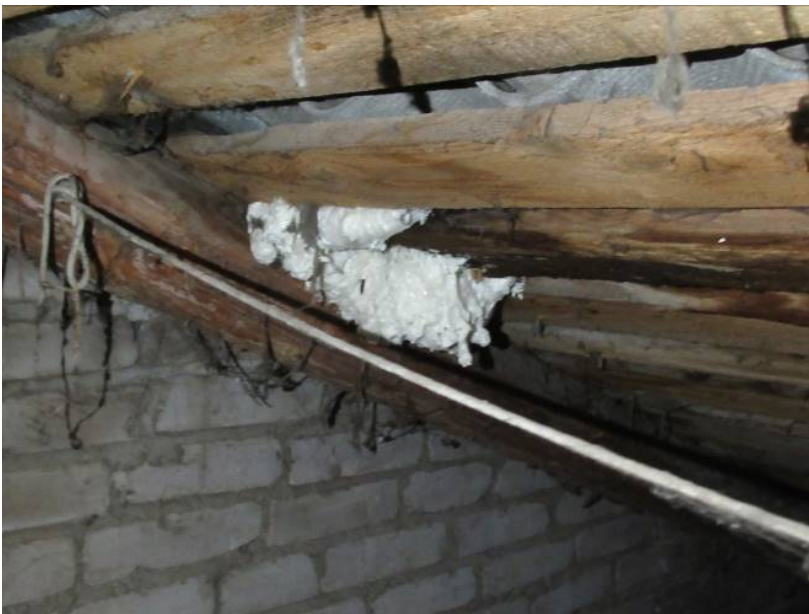
Фото 17. Вид выполненного ремонта протечки кровли здания с гнилостным повреждением обрешетки и стропил заполнением монтажной пеной. Протечки данным «ремонтом» не устранены.
