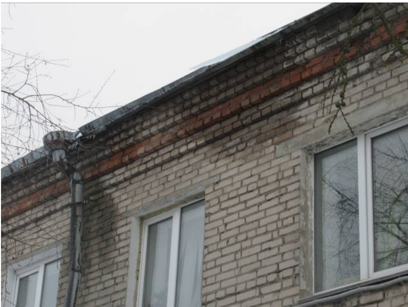
Фото 3. Вид состояния фасадной стены здания. Присутствует намокание кладки вследствие протечек кровли.
