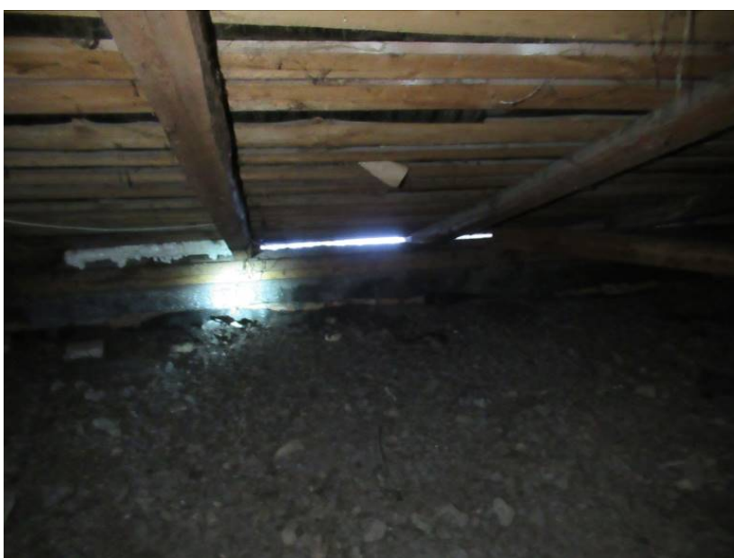
Фото 15. Вид сохранившегося не заполненного монтажной пеной вент. зазора над мауэрлатом. В качестве стропильной ноги установлена доска плашмя без подкоса.
