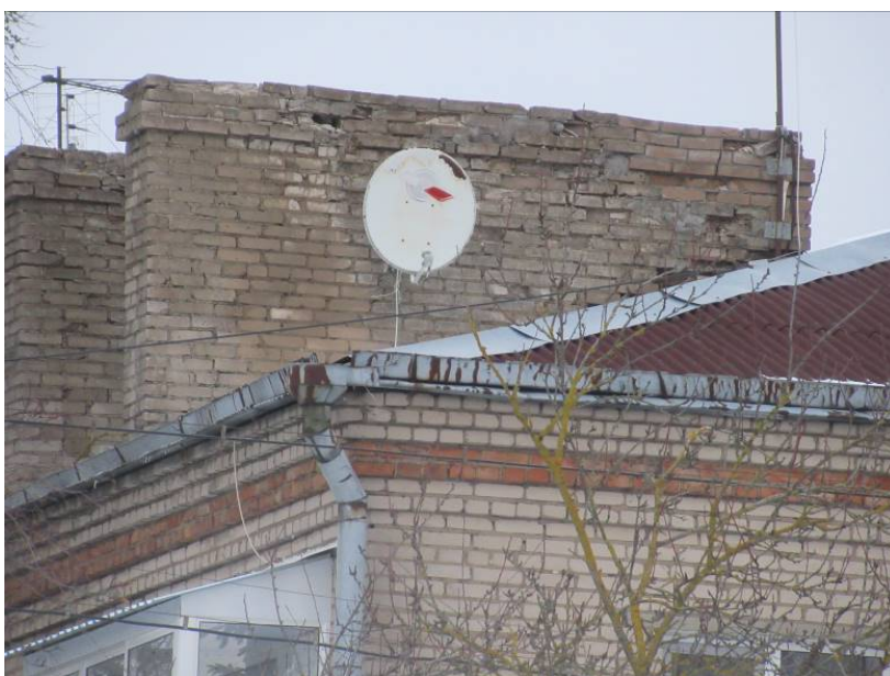
Фото 5. Вид состояния первого по ходу осмотра выпуска вент. канала над крышей здания. Водоотливное покрытие над кладкой вент. канала отсутствует полностью, как всех остальных в здании. Следы многолетних намоканий их кладки имеются.
