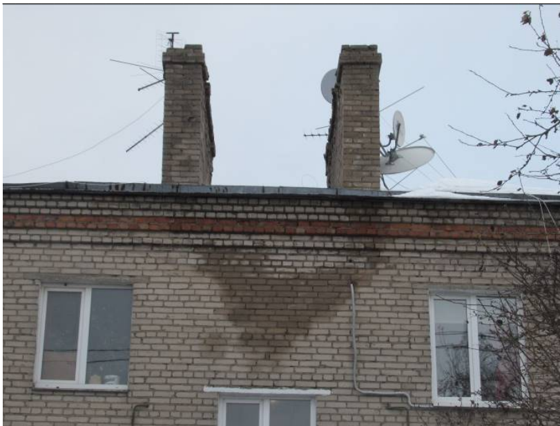
Фото 4. Вид состояния фасадной стены по длине здания. Также присутствует намокание кладки вследствие протечек кровли.
